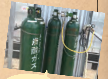
CO2環境制御で使用しているボンベ
